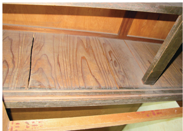
図27 収納棚の内部の底板（元々は杉材無垢板の巾接ぎ）
